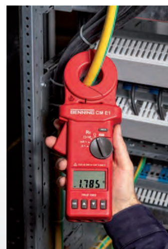
Messung des Betriebserders einer Industrieverteilung
