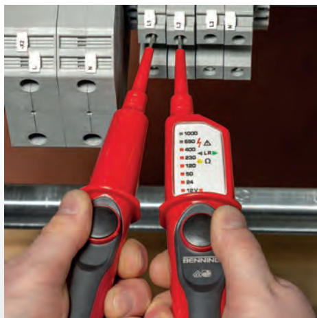
Drehfeldprüfung an den Ausgangsklemmen einer USV
