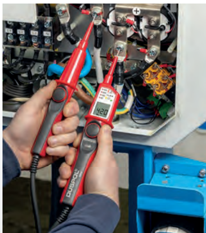
Prüfung der Ausgangsspannung einer DC-Ladeeinrichtung
