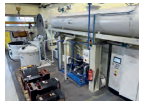
Die neue Tränkanlage ist ausgelegt für Wickelgüter bis zu 2 m Durchmesser und 3 m Länge
